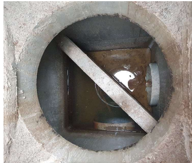
Overstortmuur in rioolput
