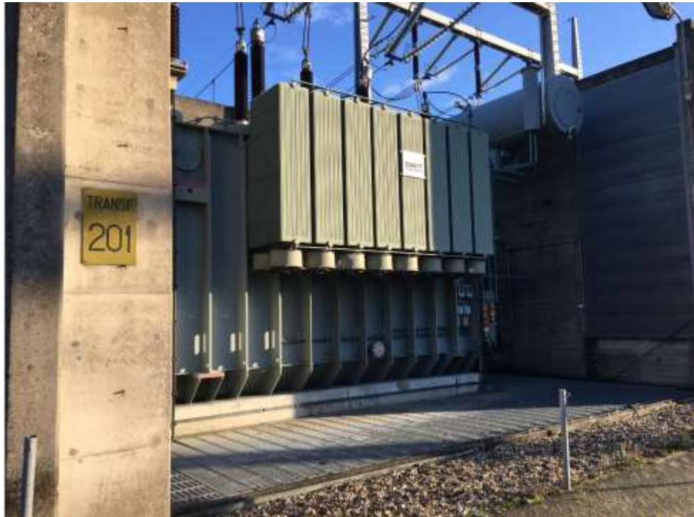
Figuur 4.5 Bestaande koppeltransformator in transformatorcel
