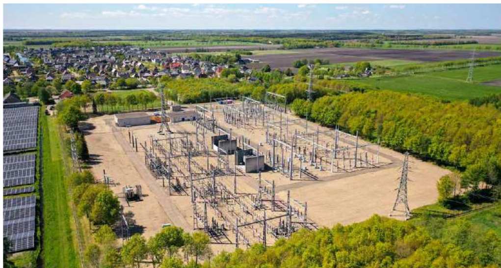
Figuur 3.2 Bovenaanzicht van het huidige transformatorstation Zeijerveen
