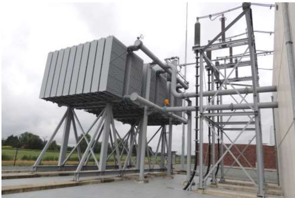
Figuur 4.4 Aanzicht koeler op vergelijkbaar TenneT-station
