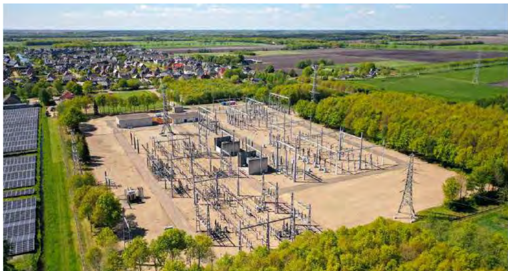
Figuur 3.2 Bovenaanzicht van het huidige transformatorstation Zeijerveen
