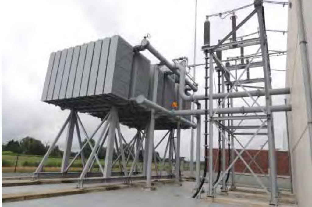
Figuur 4.4 Aanzicht koeler op vergelijkbaar TenneT-station
