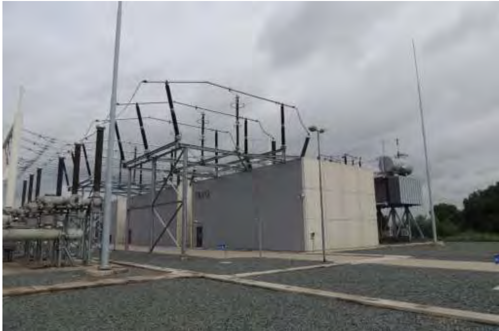
Figuur 4.3 Aanzicht transformatorcel met geluidshuis en portaal op vergelijkbaar TenneT-station
